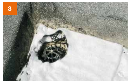
Im Bereich von Dachabläufen SDF-Matte ausschneiden. Kann kein Kontrollschacht aufgestellt werden, Dachablauf mit Grobkies einfassen – vgl. Checkliste.
