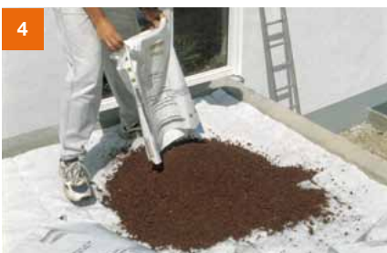
Unmittelbar im Anschluss pro Quadratmeter zwei Sack Pflanzerde einbauen. Bauder SDF-Matte nicht ohne Auflast liegen lassen.
